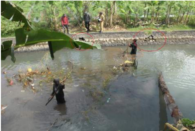
Gambar 4.3 Kerusakan di Beberapa Saluran Irigasi Subak Lukluk
